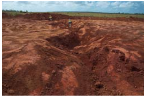
Retiro de sobrecarga revela anomalías ocultas, tales como esta vieja línea de drenaje
